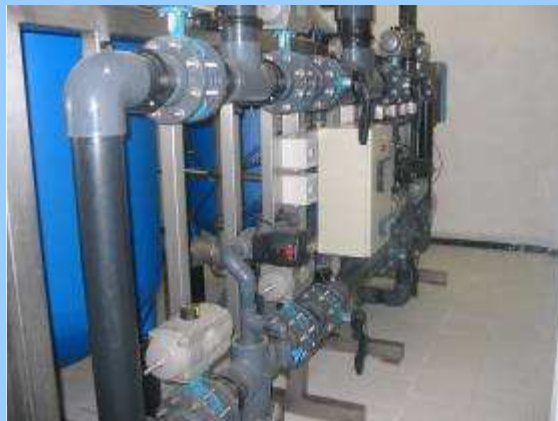
Adoucisseur d'eau duplex, piloté par un coffret électrique central et asservissant un jeu de vannes pneumatiques 50 m 3 /h
