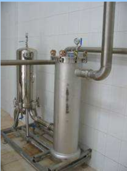
Skid de filtration 35 m 3 /h,
