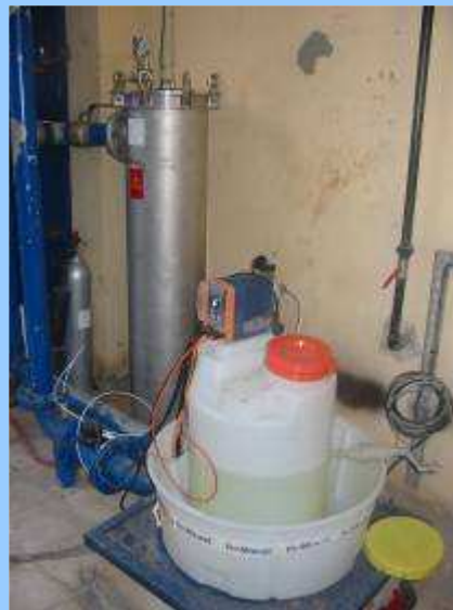
Chloration avant stockage
